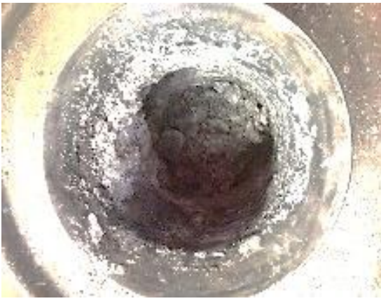
Kuva SCR -sekoitinputkesta, joka on toiminut alle 260°C lämpötilassa.
